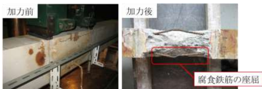
図 1.3 曲げ載荷試験前後の RC 梁部材の外観 3)
