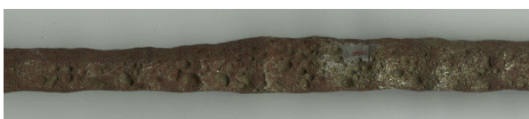
図-19 実構造物から採取した鉄筋 No.5 10) の外観
