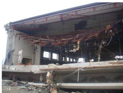
図-1 津波による体育館の外壁の転倒[1]
