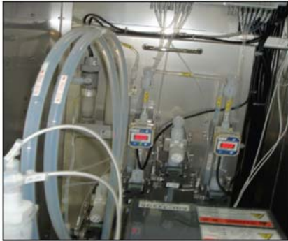
熱交換器設置前
