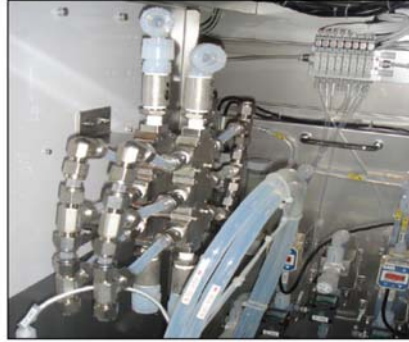
熱交換器設置後
