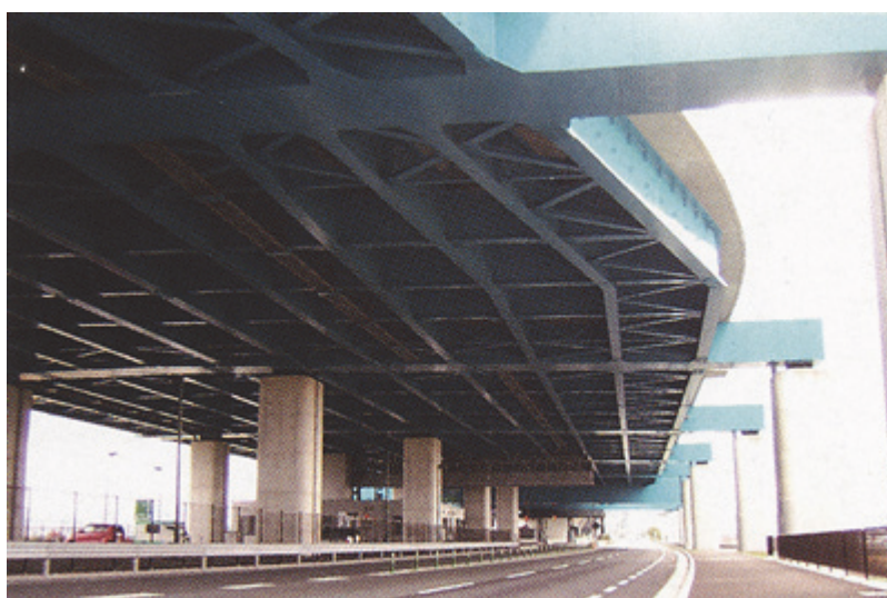
図 1.1 鋼製多主桁橋の外観図の例（洛南連絡道路，IHI インフラシステム HP より）
