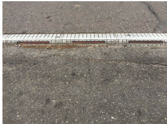
図 3.4 赤丸内の段差
