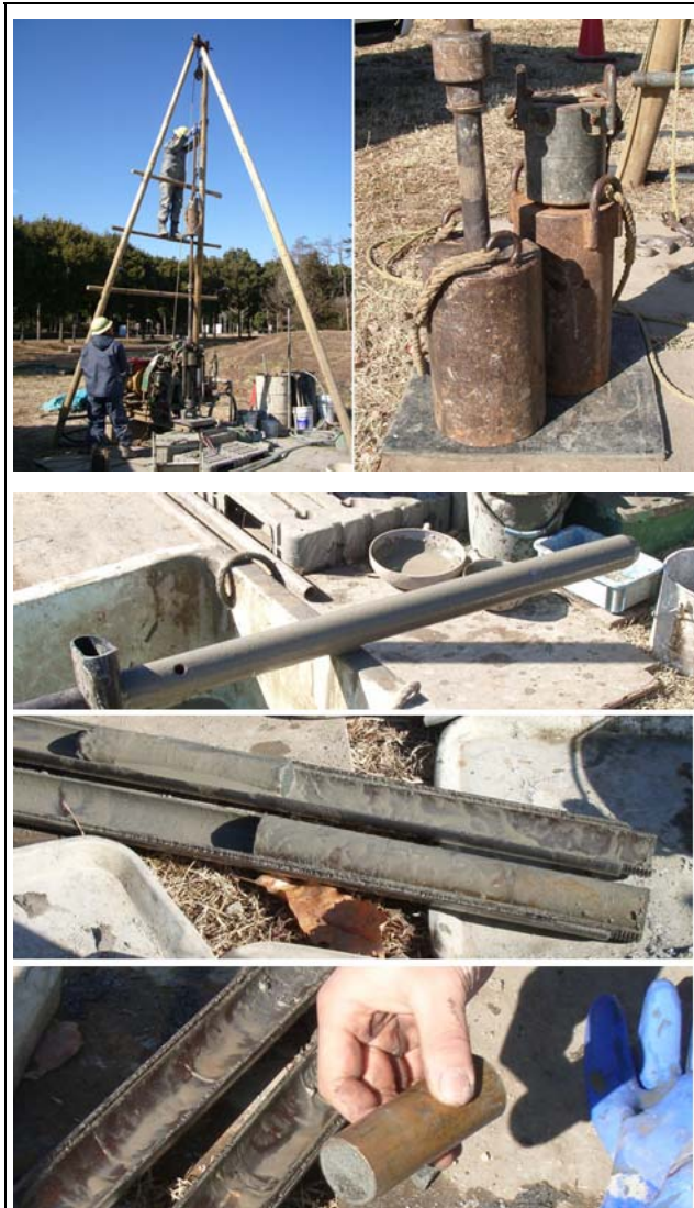
図-1.3.1 標準貫入試験の様子(写真左上)と用いるハンマー(右上)、2つ割りのサンプラー(中)と得られた土質試料の例(下)
