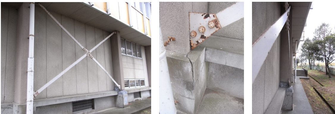
写真7 体育館鉛直ブレースの座屈と柱脚鉄筋コンクリート基礎部のひびわれ（新東小学校）
