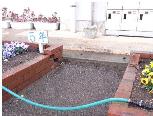
写真6 校舎棟と地面の段差（ずれ）（新東小学校）
