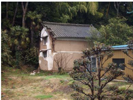
写真5 土蔵の妻面壁の剥落と屋根の損傷（江戸崎地区）
