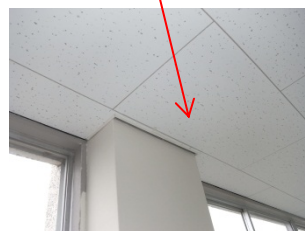
(天井板と柱の隙間)
