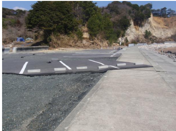
図11 駐車場の剥離したて流された舗装面
