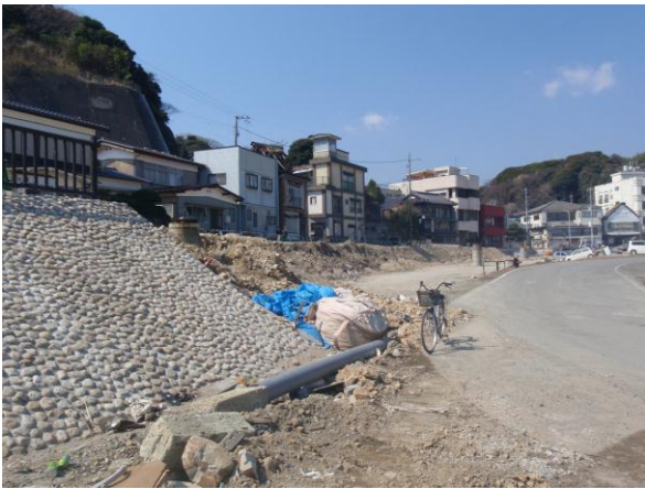
図4 工事途中の法面の被災
