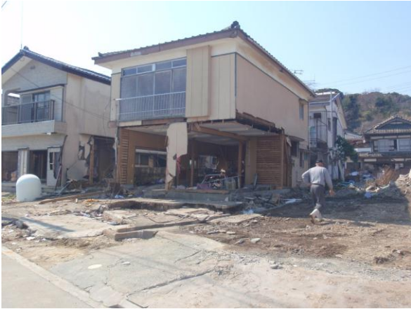
図8 護岸背後被災住宅
