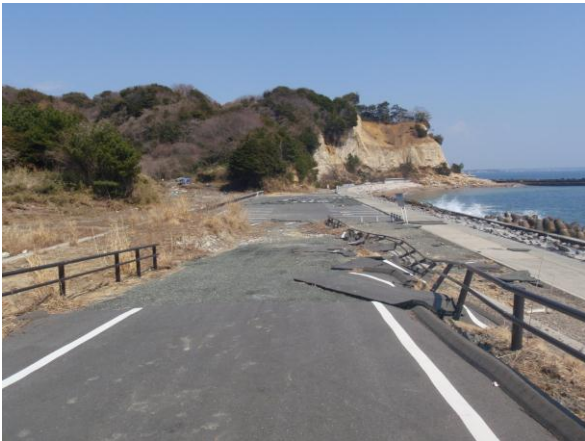
図10 取り付け道路と手すりの変状
