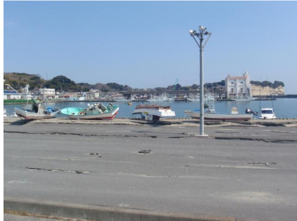
図 35 大津漁港西端部の埠頭の被災
