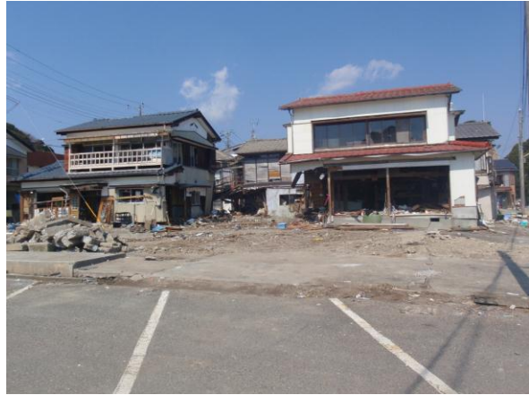
図9 護岸背後被災住宅
