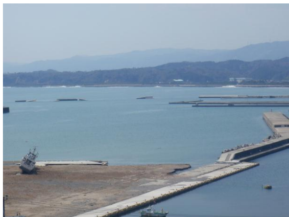
図 28 沖防波堤の倒壊
