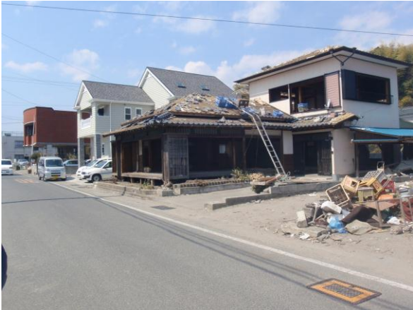
図 34 県道 27 号沿道家屋の被災
