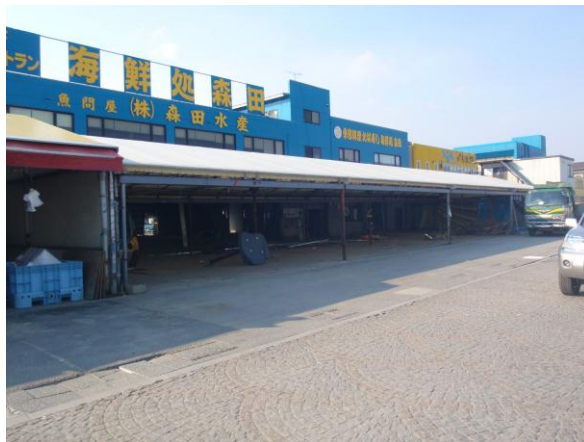
図 45 那珂湊漁港の海産物の直売施設の被災
