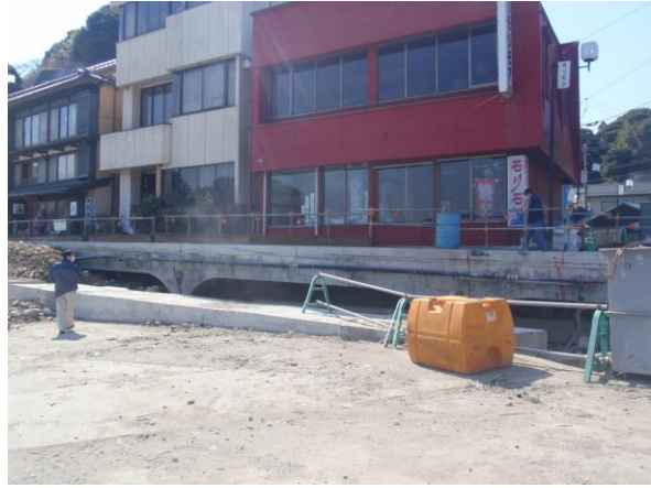
図3 工事途中箇所の被災
