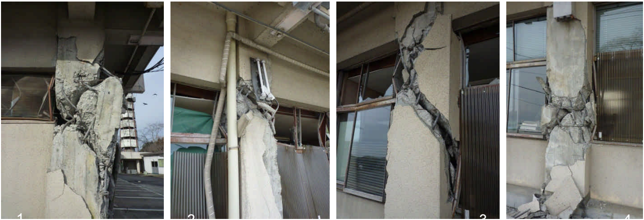
写真 18 笠間市役所笠間支所の柱のせん断破壊
