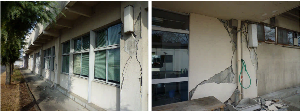
写真 19 笠間市役所笠間支所の柱および袖壁付き柱のせん断破壊
