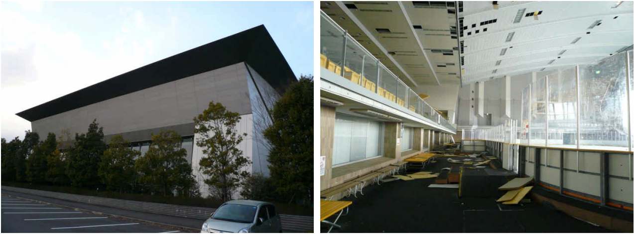
写真 16 笠松運動公園（屋内水泳プール兼アイススケート場）の天井パネルの落下
