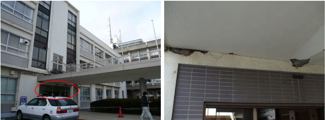
写真 11 日立市役所の渡り廊下の損傷
