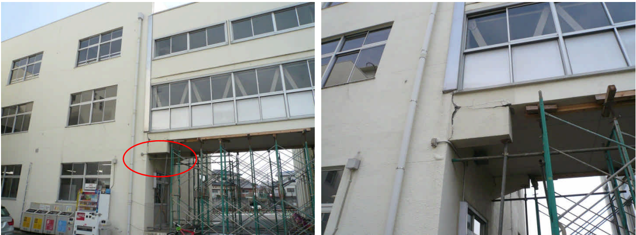
写真 10 日立市役所の張出し部損傷
