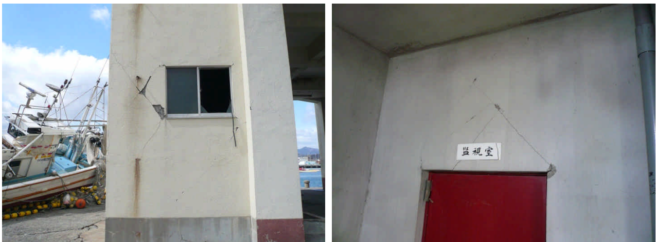
写真4 漁協建物の壁のひび割れ
