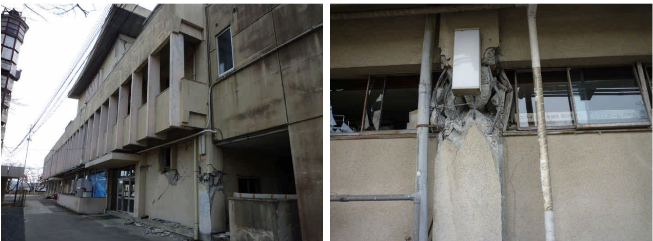
写真 20 笠間市役所笠間支所の柱のせん断破壊または軸方向破壊
