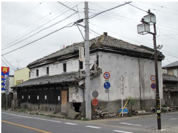
写真 17 土蔵 瓦屋根の崩落
