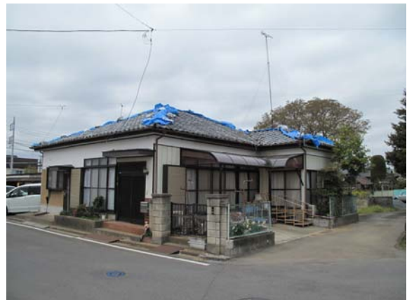
写真6 大宮小学校前 木造住宅瓦被害
