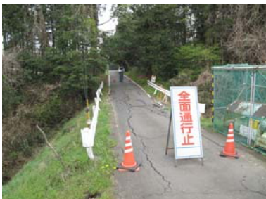
写真 34 車道亀裂通行止め
