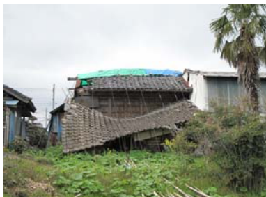
写真 23 木造付属屋下屋崩壊
