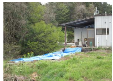
写真 36 崖地崩れ 下屋傾斜
