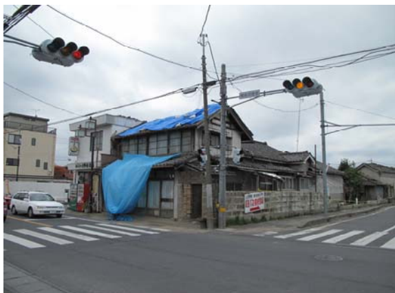
写真13 木造住宅 屋根瓦の崩落
