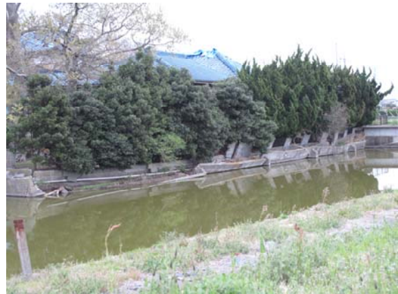
写真 44 池側に傾斜するブロック塀
