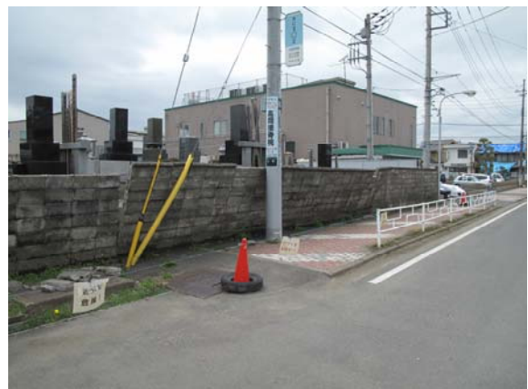
写真8 大宮小学校前 ブロック塀倒壊
