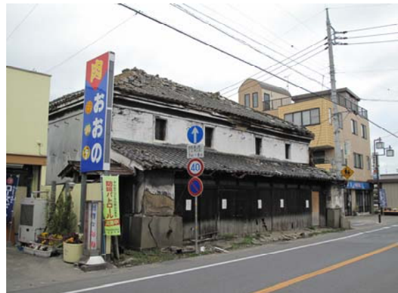
写真 18 土蔵 一部漆喰の崩落
