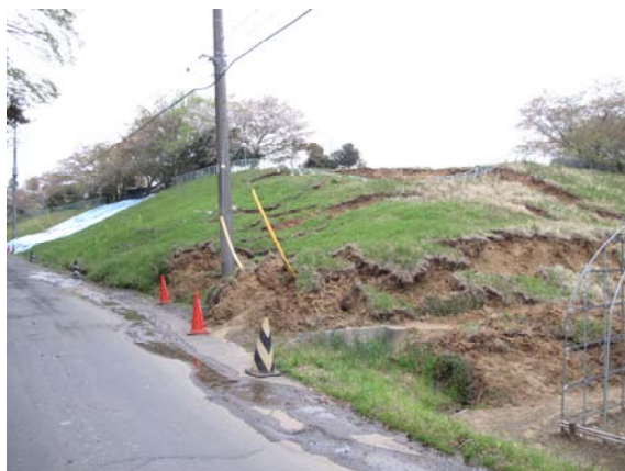
写真 42 小学校敷地近傍での土砂崩れ
