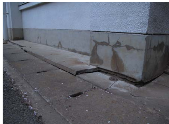
写真 46 地盤沈下による柱脚のずれ
