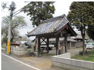
写真 24 四脚門屋根葺土の崩れ
