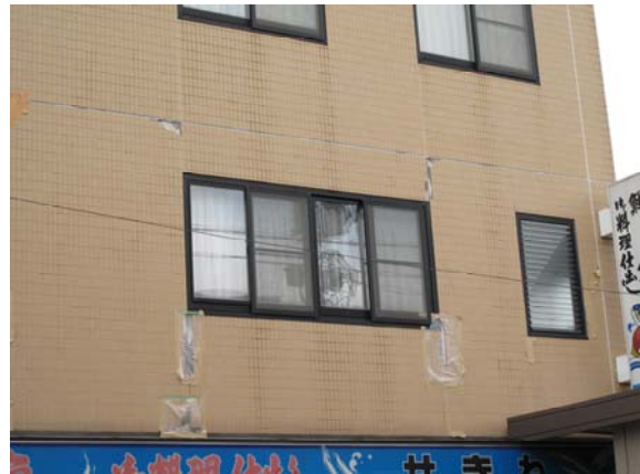
写真 16 タイル壁剥落詳細
