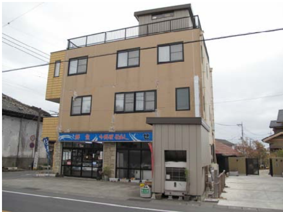
写真 15 鉄骨造住宅 タイル壁の剥落
