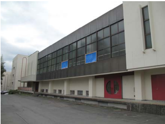
写真5 大宮小学校 体育館 窓ガラス破損
