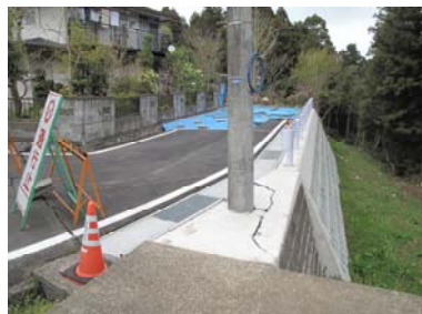
写真 35 車道 崖地の崩れ
