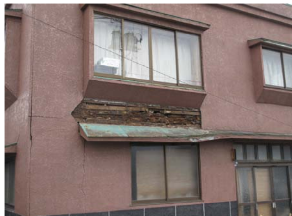
写真 20 外装材被害詳細
