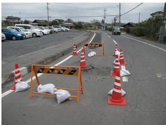
写真 26 マンホールの隆起
