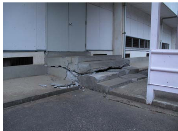
写真 48 体育館入口階段の崩壊
