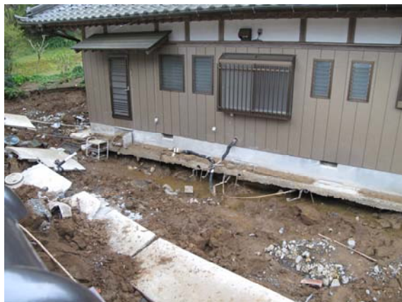
写真 40 剥き出しになった基礎
