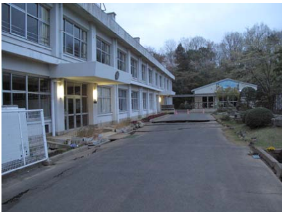
写真 45 地盤変状による歩道の亀裂
