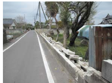
写真 25 大谷石塀の崩壊
