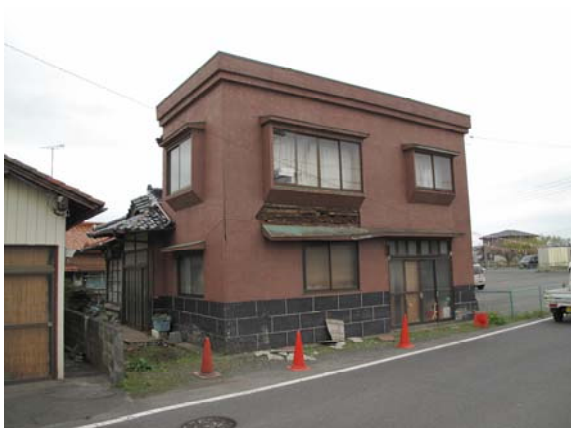
写真 19 木造住宅 外装材の崩落及びひび割れ
