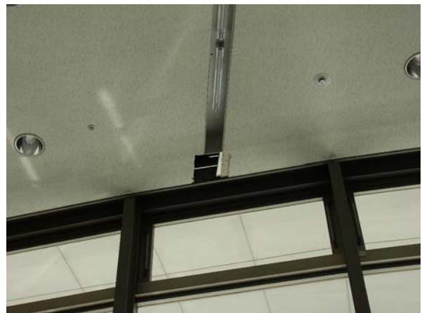
照明器具と天井の取合部の損壊
