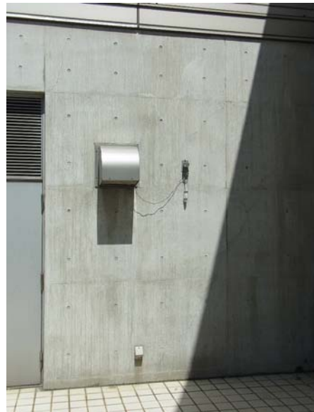
1階耐力壁の斜めひび割れ
