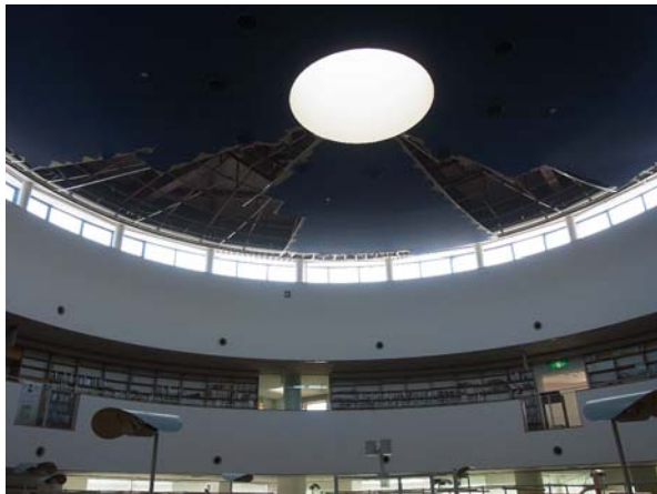
吹き抜け部天井パネルの損壊
