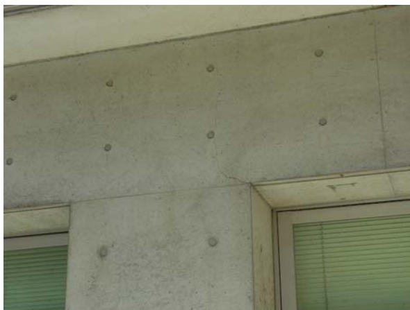
梁端部の曲げひび割れ
