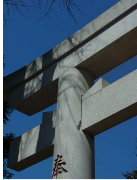
鳥居仕口部の損傷
