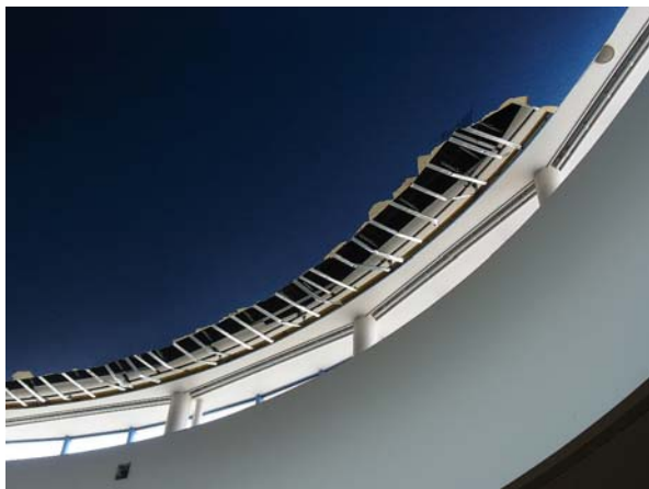
吹き抜け部天井パネル隅部の損壊
