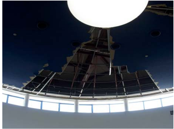
天井パネル落下部の下地材
