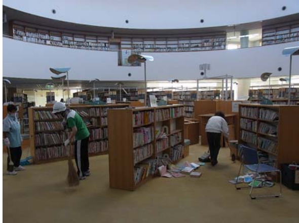
落下した天井パネルの清掃作業（2階）
