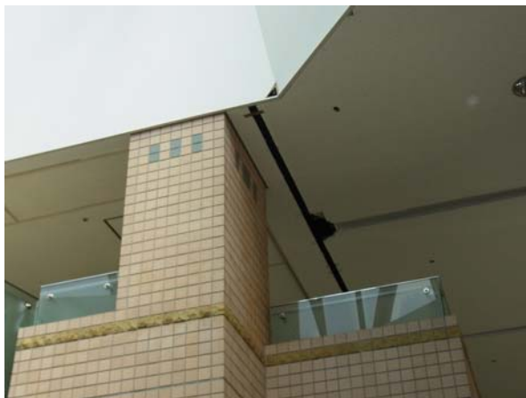
天井パネルの損壊
