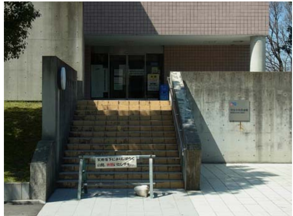
天井落下による休館案内
