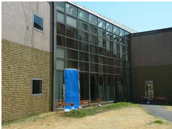
ガラスの損壊
