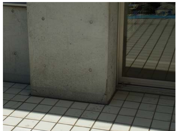
柱脚部の圧縮ひび割れ
