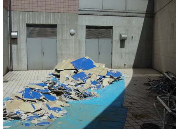
落下した天井材
