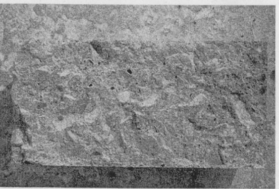
写真1 粗骨材も引張性能から見る と断面欠損となる
