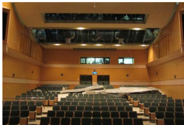
図-1 ホールにおける天井脱落被害の様子[1]
